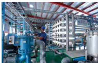
海水淡水化装置
